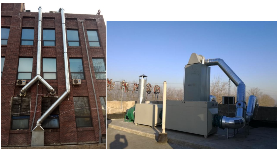
图 4-5 废气治理设施
