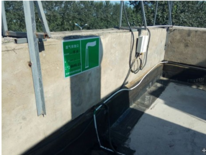
图 4-6 废气排口标示
